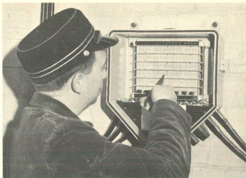
De nieuwe telefoonbekabeling.
